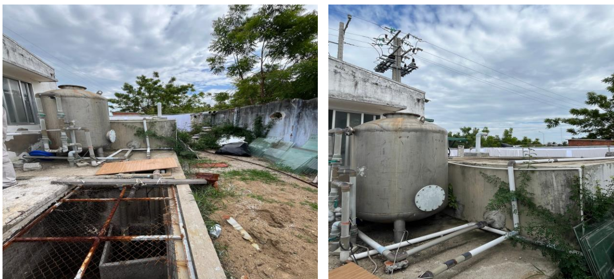
Hình 3-5: Hệ thống xử lý nước thải
